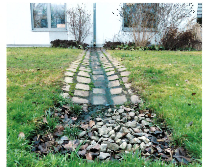
Das Regenwasser versickert über Mulden und in unterirdischen Rigolen.
